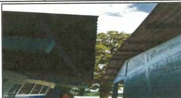
Foto 8: FALTA DE CANAL DE AGUA PLUVIAL MODULO II
