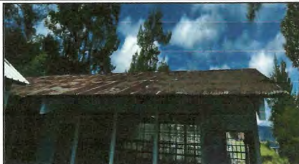
Foto 2: SUSTITUCION DE TECHO POR MAL ESTADO
