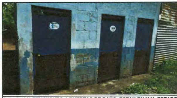
Foto 6: MANTENIMIENTO A PUERTAS DE BAÑO, ESTAN EN MAL ESTADO POR CORROSION
